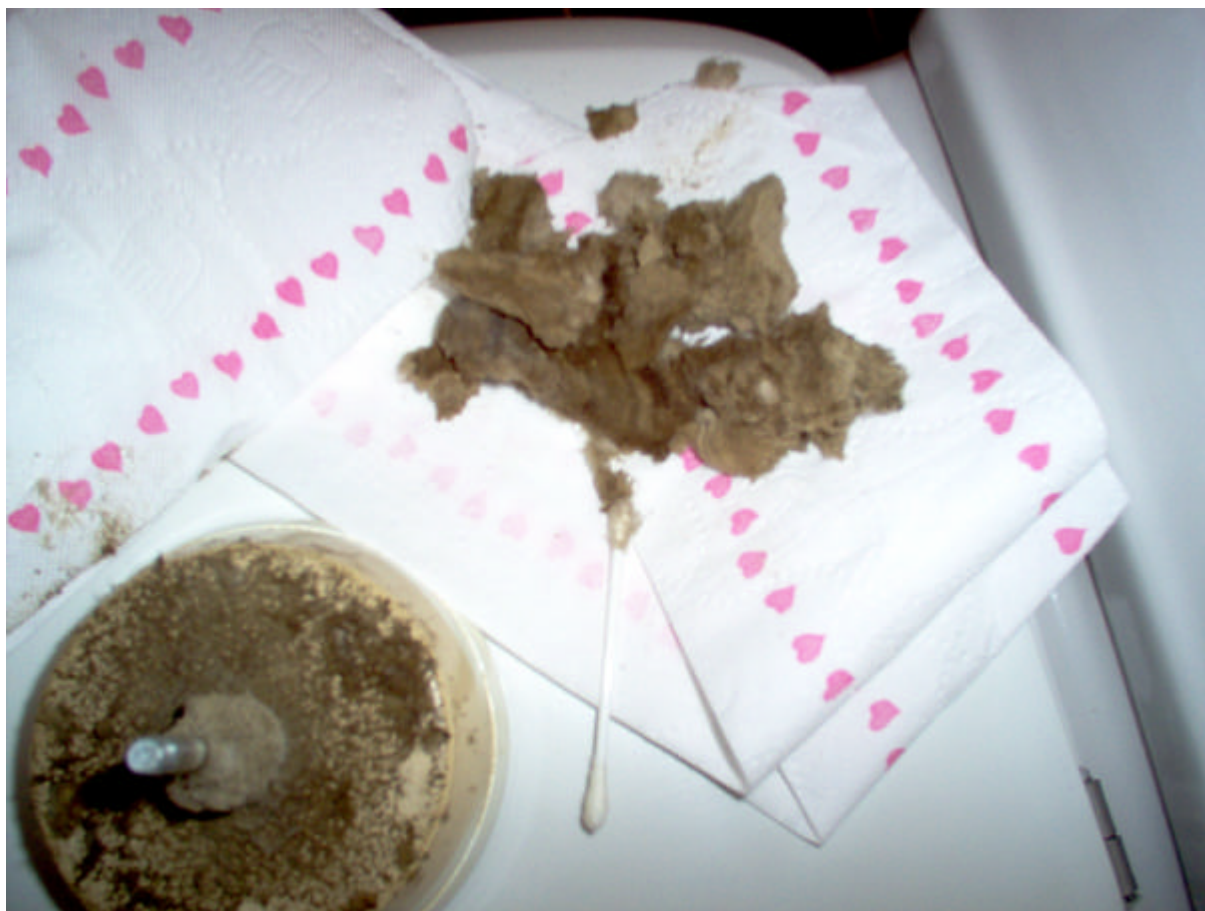
Figur 8 . Avtrekksventil etter 3 års normal bruk (Kilde: Frode Stenberg)
